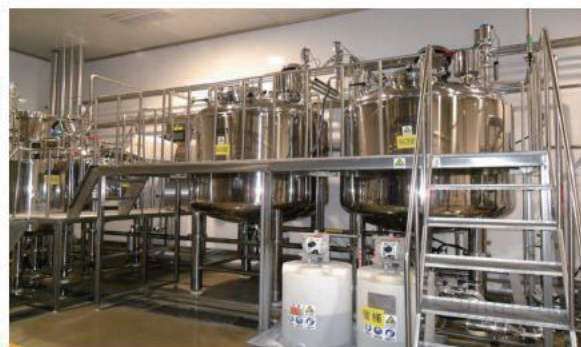
SAC貯蔵タンク
